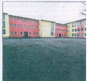
Der Bitumen auf dem Schulhof bröseln. Er wurde im Jahr 1976 erneuert.
